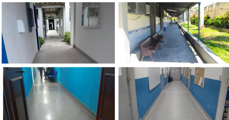
Figura 27 - Ausência de piso tátil nas unidades de Angra dos Reis, Maria da Graça, Petrópolis e Valença
