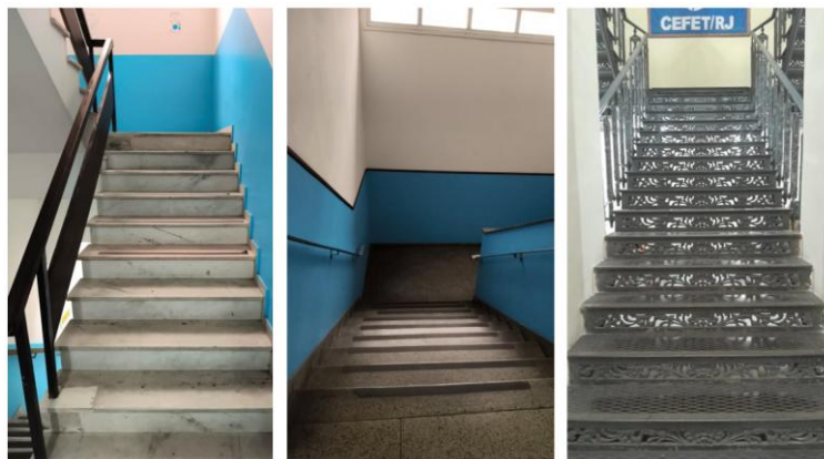
Figura 63 - Escada sem corrimão duplo e piso tátil na entrada e saída
