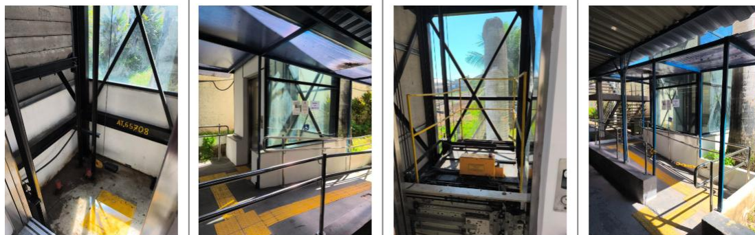
Figura 69 – Elevador fora de uso
