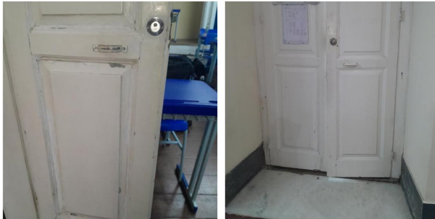
Figura 50 - Maçaneta fora do padrão
