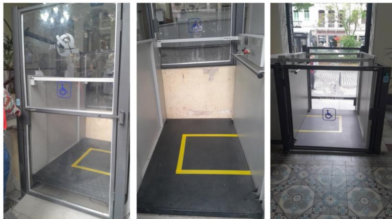
Figura 36 – Plataforma elevatória dentro do padrão
