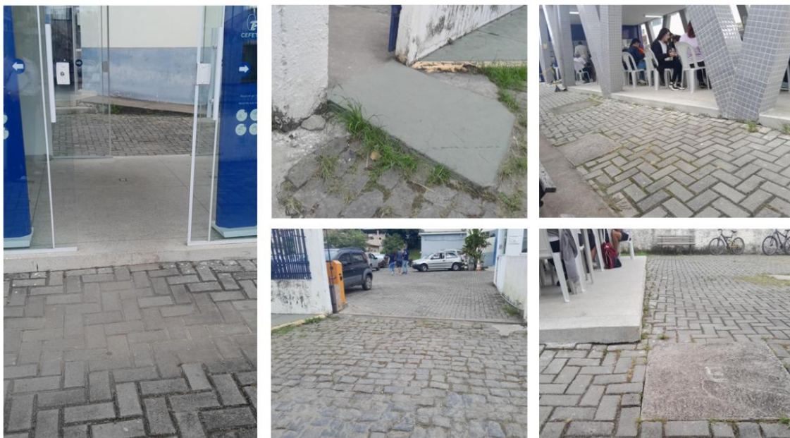
Figura 13 – Obstáculos nas entradas e no acesso ao restaurante (Valença)
