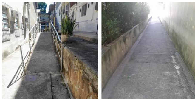
Figura 62 - Rampa de acesso ao restaurante sem piso tátil
