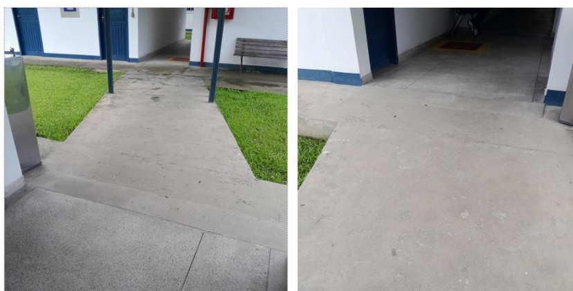
Figura 60 - Rampa sem piso tátil na entrada e saída
