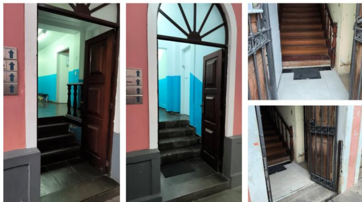
Figura 12 - Degráus no acesso aos blocos D e E e no acesso à biblioteca (Petrópolis)
