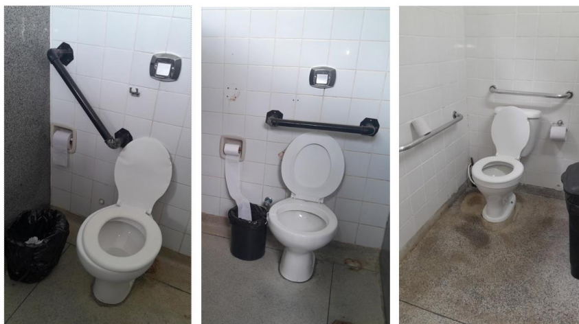
Figura 57 - Barras de apoio e descarga fora do padrão
