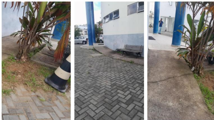
Figura 65 - Rampa sem piso tátil e corrimão
